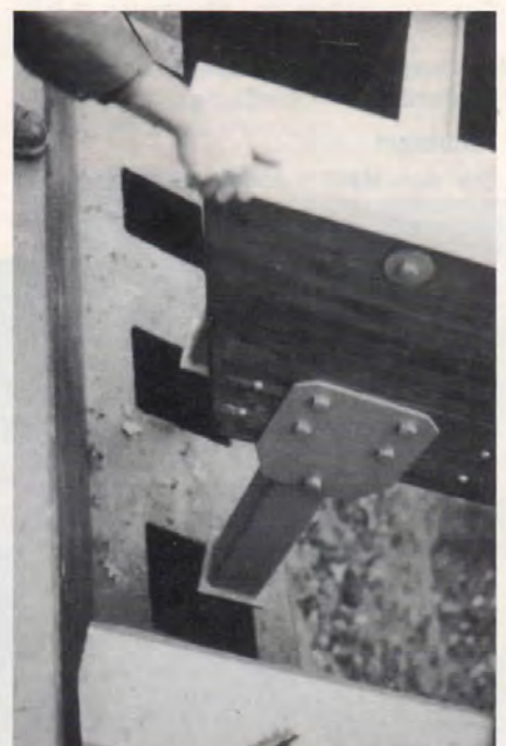
Bild 19: Die Einspannprofile werden an den vormontierten Trägerpaaren hängend in die Aussparungen der Widerlager eingefahren.
