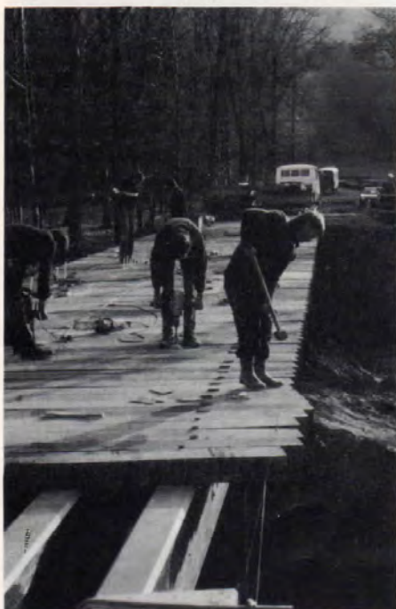
Bild 17: Die Bohlen wurden auf der Baustelle ausgesucht und durch schräg eingeschlagene Stabdübel auf dem Hauptträger befestigt.
